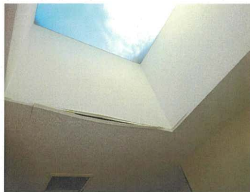
⑭ 雨漏り箇所
