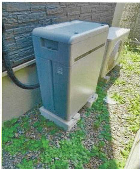
蓄電池ユニットの設置状況
