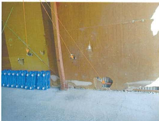
⑦ 内壁損傷箇所
