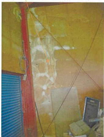
⑨ 雨漏り跡
