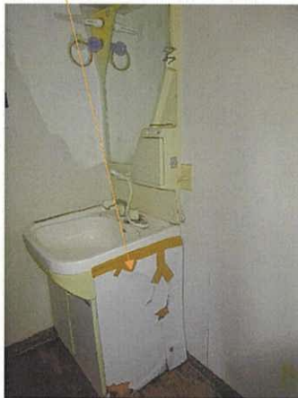
④⑤ 洗面台損傷
