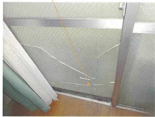
④④ 窓ガラス損傷
