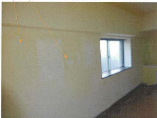
③⑦ 壁クロス汚れ
