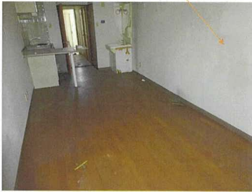
④③ 402号室 壁クロスの汚れ等
