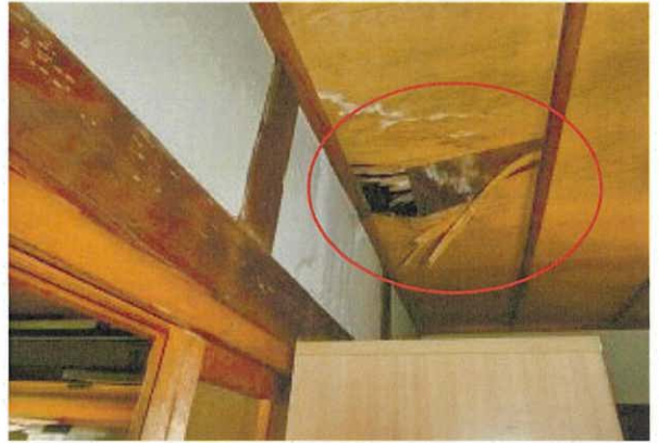
天井の損傷状況
