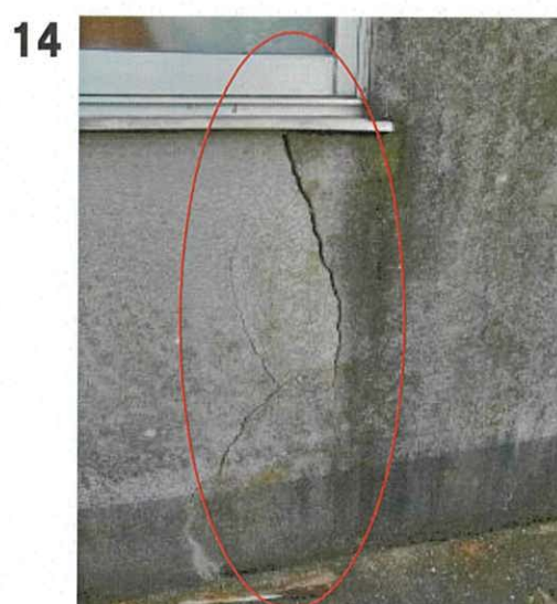
外壁（増築部分）のヒビ割れの状況
