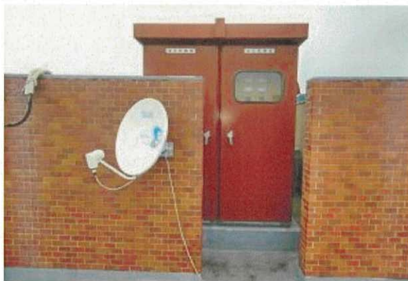
キュービクルの状況
