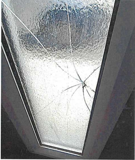
7 (玄関扉のガラスの状況)
