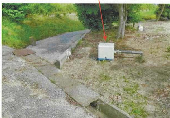
汲み上げポンプの状況
