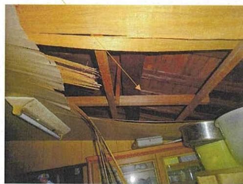
③⑥ 天井損傷
