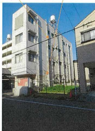
② 物件2 外壁汚損
