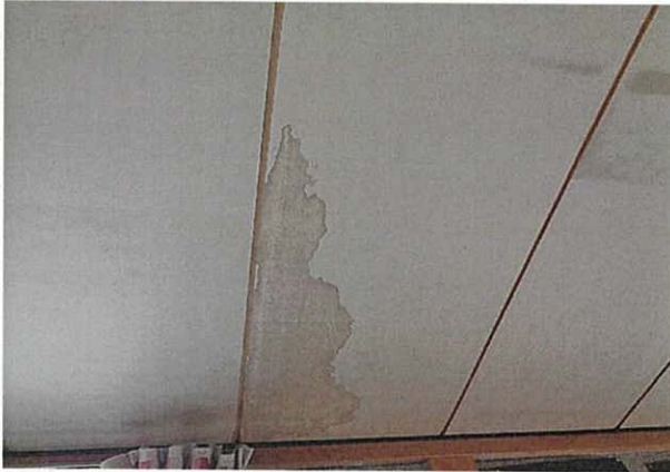
25 (天井板のシミの状況)
