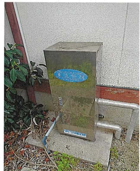
10 (浄化・活水システムの状況)
