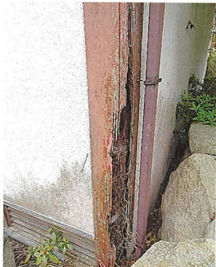
51 (柱の腐食状況)
