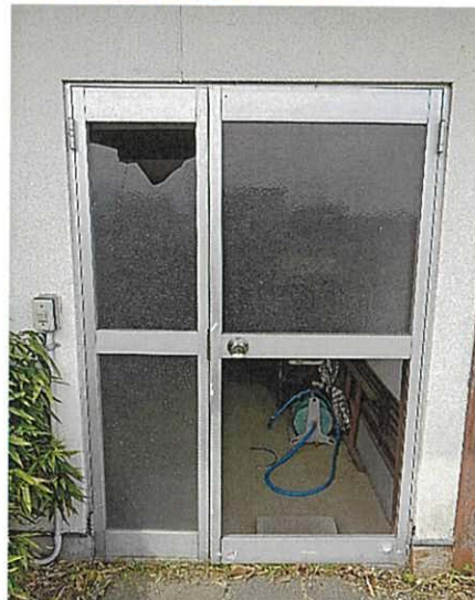
50 (ドアのガラスの破損状況)
