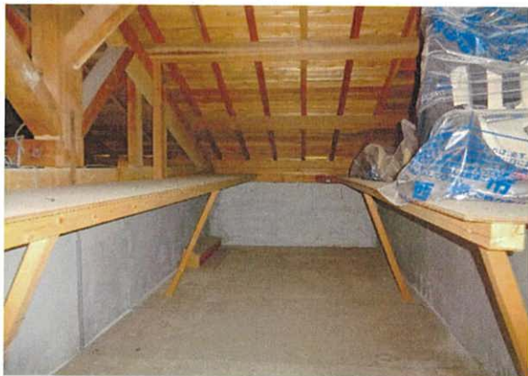
49 (小屋裏収納の状況)
