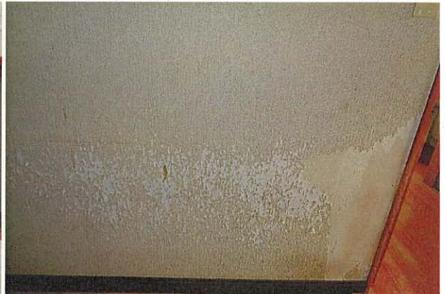
28 (内壁クロス剥がれ)
