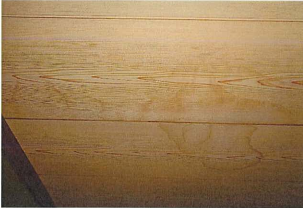
25 (雨漏り痕の状況)
