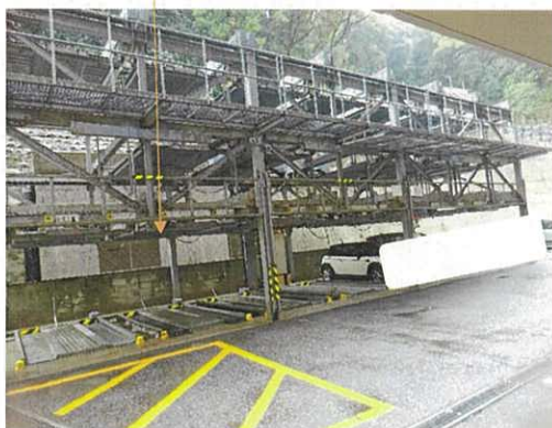
⑤ 屋外機械式立体駐車場
