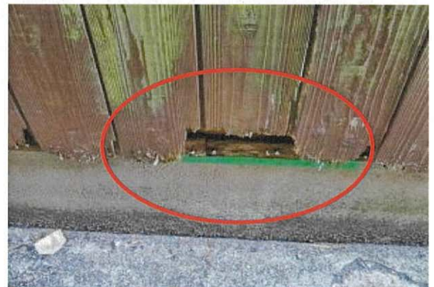
外壁の損傷状況
