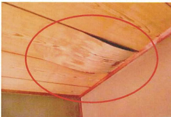
雨漏りの状況
