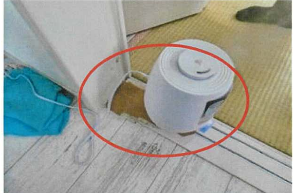
敷居部分の損傷状況
