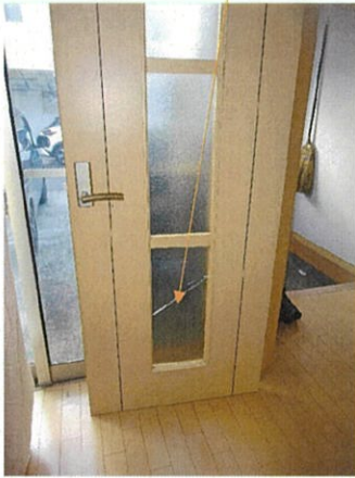
⑦ ドアガラスひび割れ
