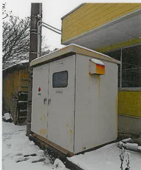
9 (キュービクルの状況)
