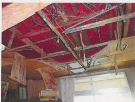
⑨ 天井損傷
