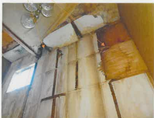
⑬ 雨漏り跡
