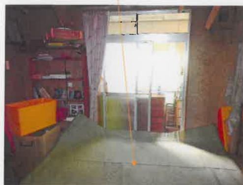
⑧ 損傷した畳の上に敷かれたカーペット
