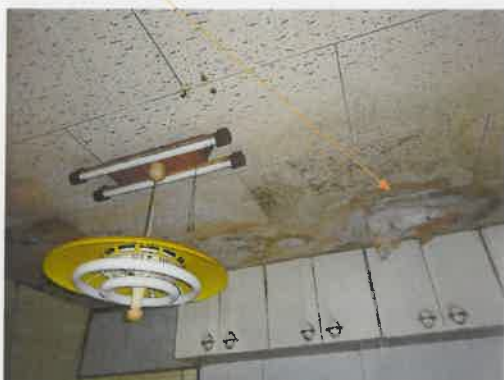
⑦ 雨漏り跡
