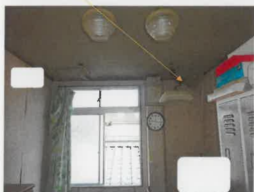
⑰ 雨漏り跡
