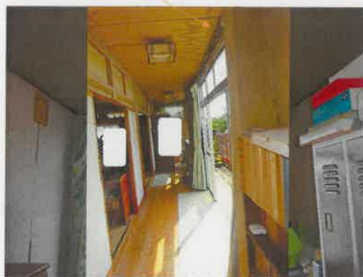
⑯ 雨漏り跡
