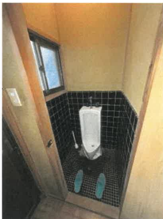
物件 2 男性用トイレの状況
