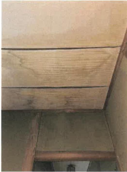
物件 2 北西側廊下天井の状況
