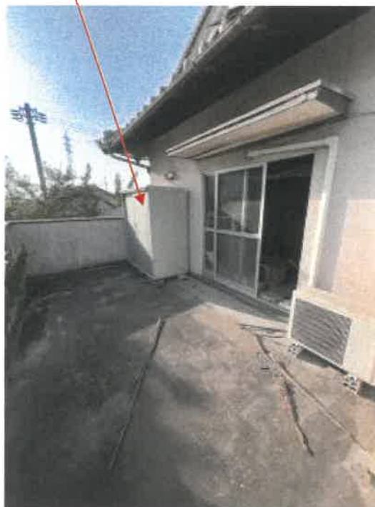
物件2 主建物2階バルコニーの状況
