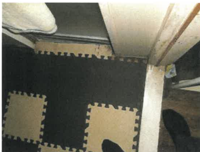
物件 2 建物の 1 階洗面脱衣所床の損傷個所の状況
