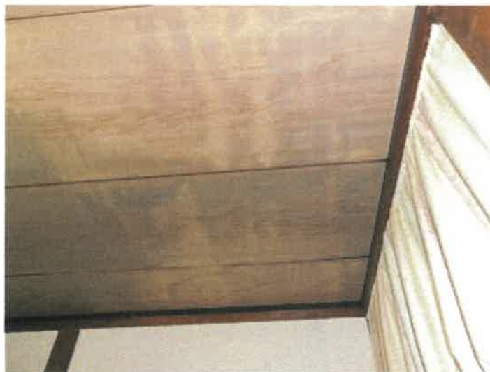
物件2建物の2階ほぼ西側和室の天井の雨漏り痕の状況
