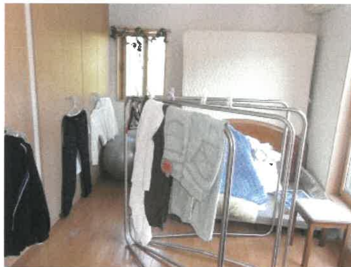
物件1 建物の2階北側東洋室の状況 壁紙の破れ
