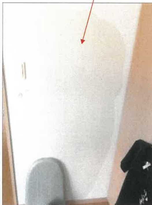
物件1 建物の2階北側東洋室の西面壁の壁紙の破れ状況
