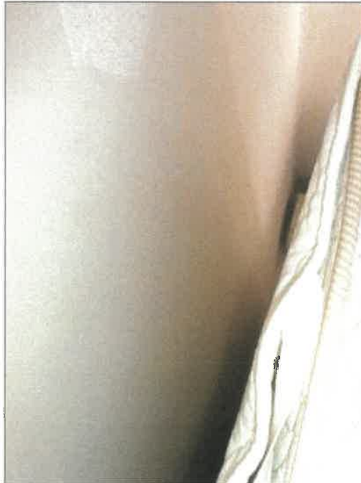
物件 1 建物の 2 階北側東洋室の東面壁の壁紙の破れ状況
