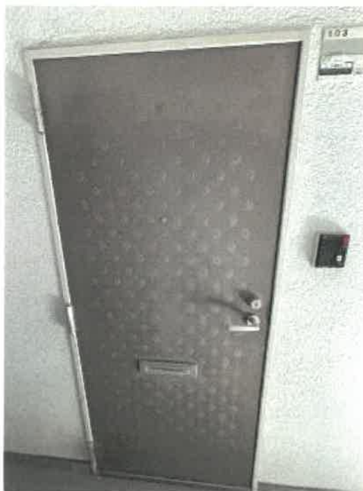
103号室入口ドアの状況
