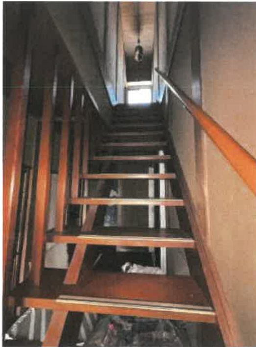
物件2 階段の状況
