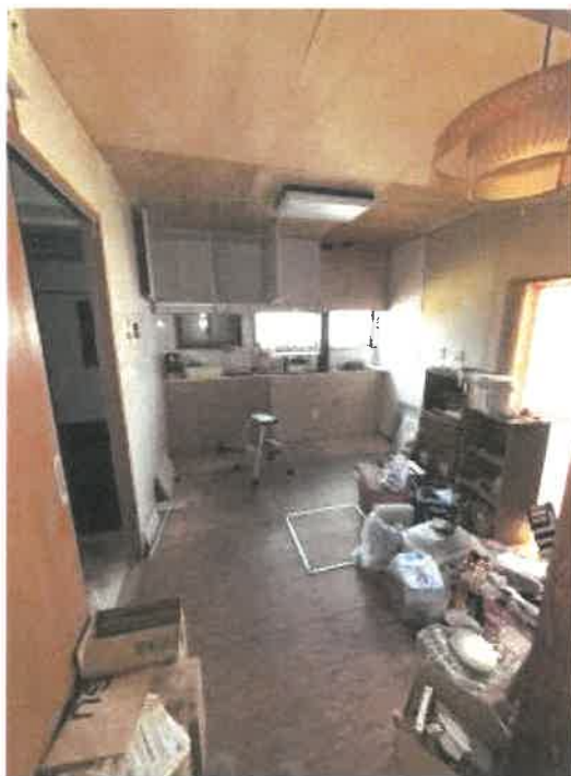
物件2 1階台所の状況
