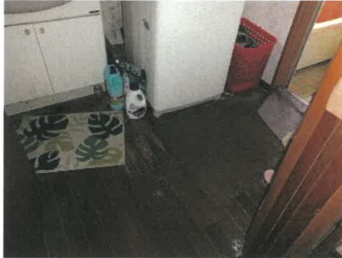
物件 2 建物の増築部分 1 階洗面脱衣所の床の損傷状況
