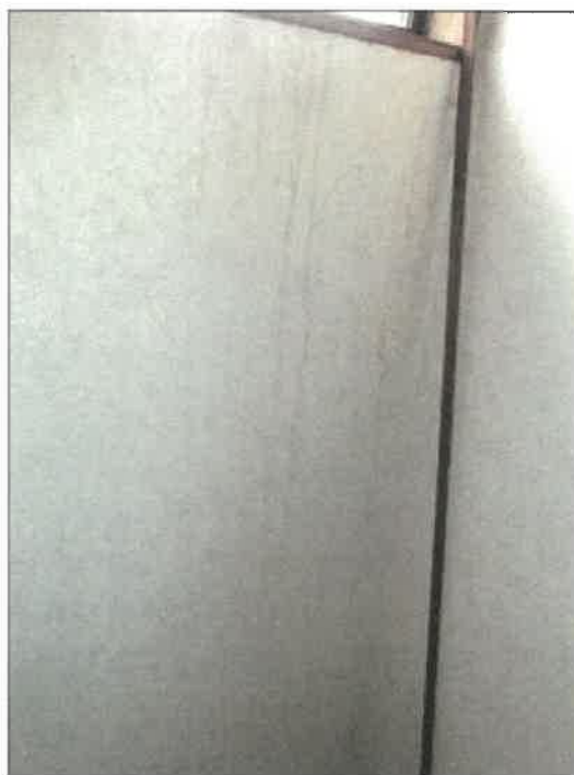
物件2建物の増築部分の階段付近壁の損傷状況
