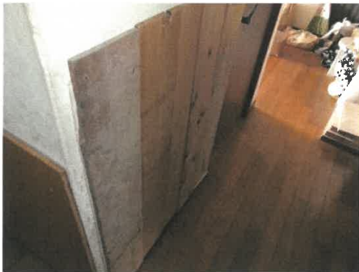
物件 2 建物の増築部分 1 階玄関付近の壁の損傷箇所の状況
