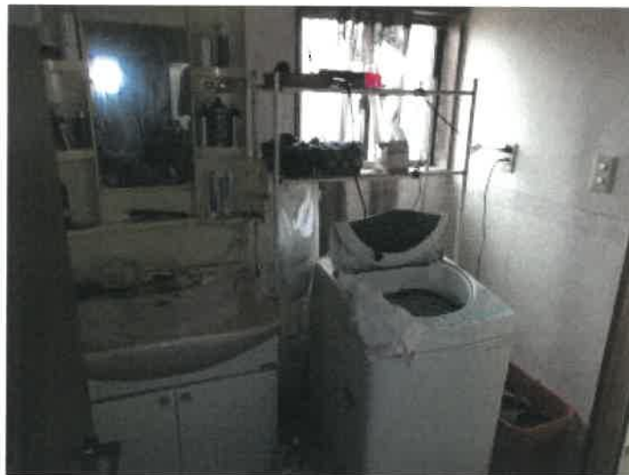
物件2建物の増築部分1階洗面脱衣所の状況
