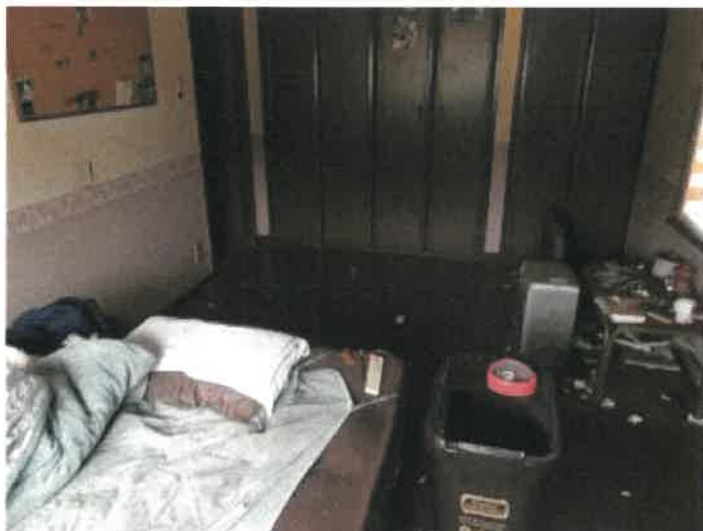
物件2建物の増築部分の2階南側東洋室の状況
