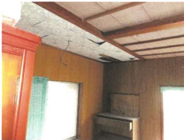
物件 2 建物の元の部分の南東角洋室の天井の損傷状況
