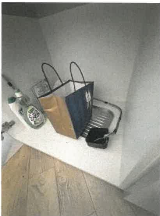
物件1 キッチン内の電線の状況
