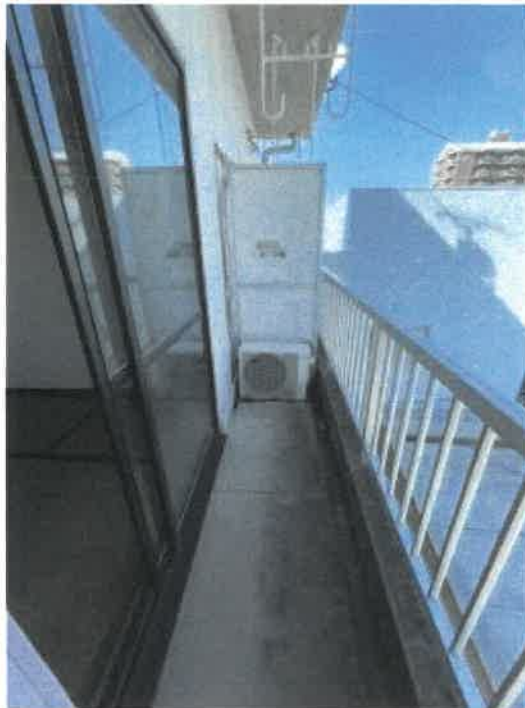
物件4 4階402号室ベランダの状況
