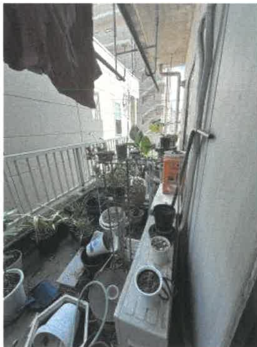
物件3 2階東側ベランダの状況
