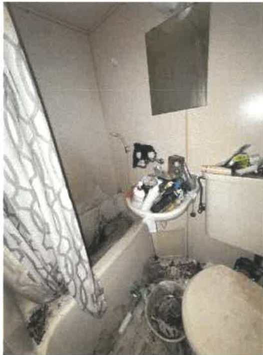
3階301号室ユニットバスの状況
