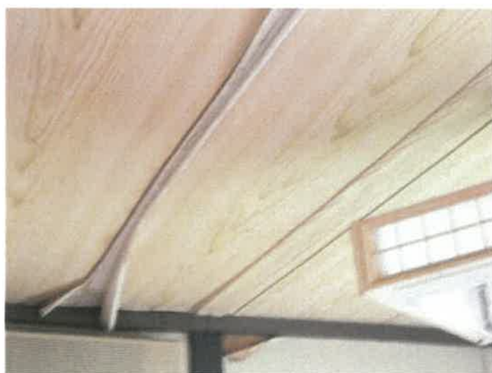
物件2建物の2階東側和室天井の損傷状況
