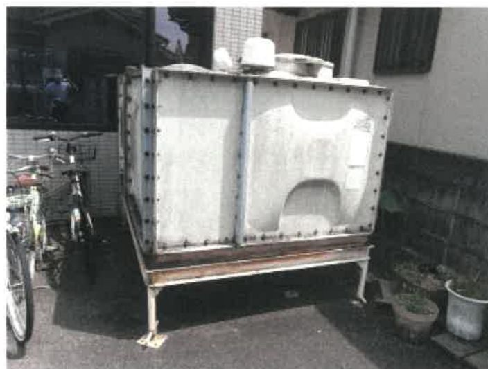
物件1，3土地南側の受水槽（動産）の設置状況
