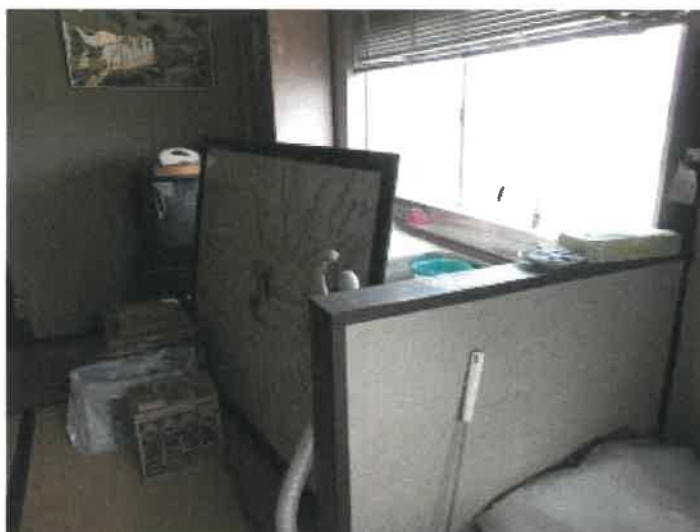
物件 2 建物の 2 階東側和室の洗面台の状況
