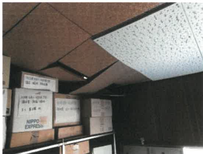
物件 3 附属建物符号 1 の物置部分の天井の損傷状況
