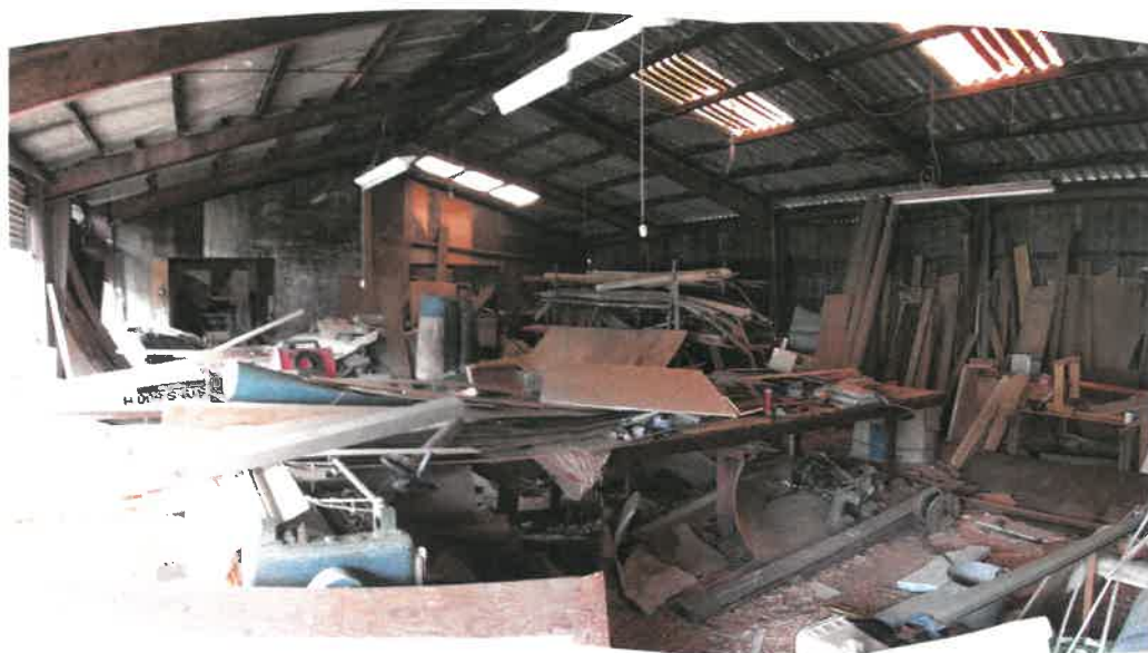
物件 3 主である建物北東側作業所内部の状況
