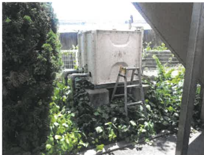
受水槽の状況
