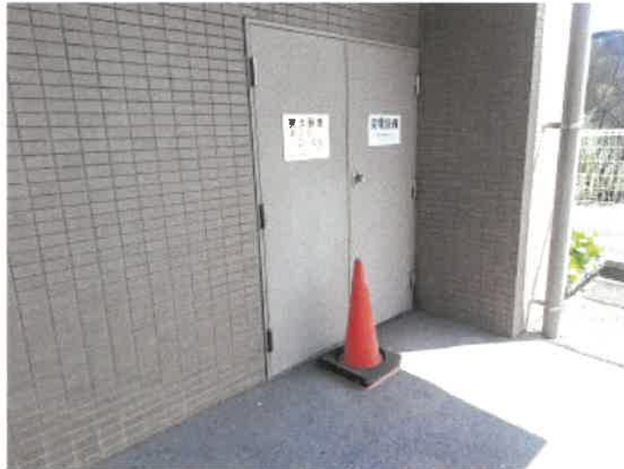
変圧器室の状況
