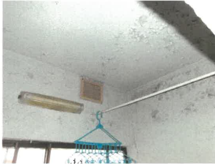
物件 2 建物の 1 階浴室の壁の損傷状況
