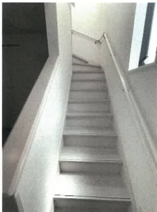
物件2 階段の状況
