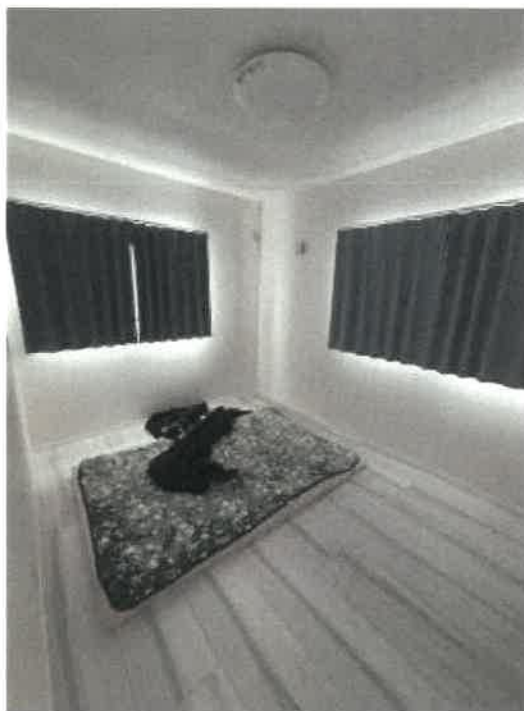
物件 2 2階南側洋室の状況
