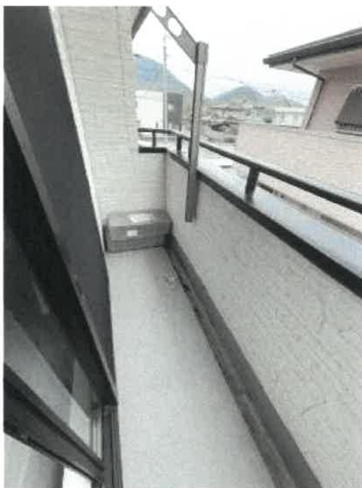
物件 2 2階バルコニーの状況
