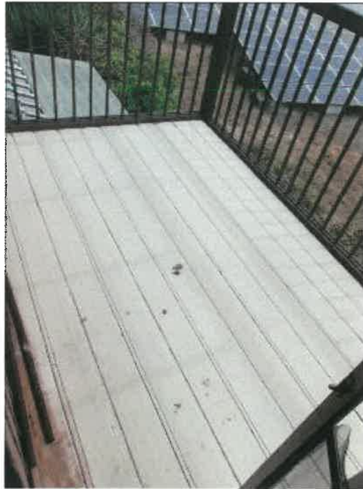
物件 5 建物の 2 階南東側のベランダの状況
