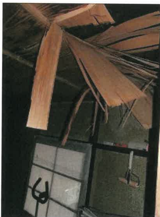
物件4主である建物の1階DK南西側和室（4．5畳）の天井の損傷状況 （雨漏りによる損壊）
