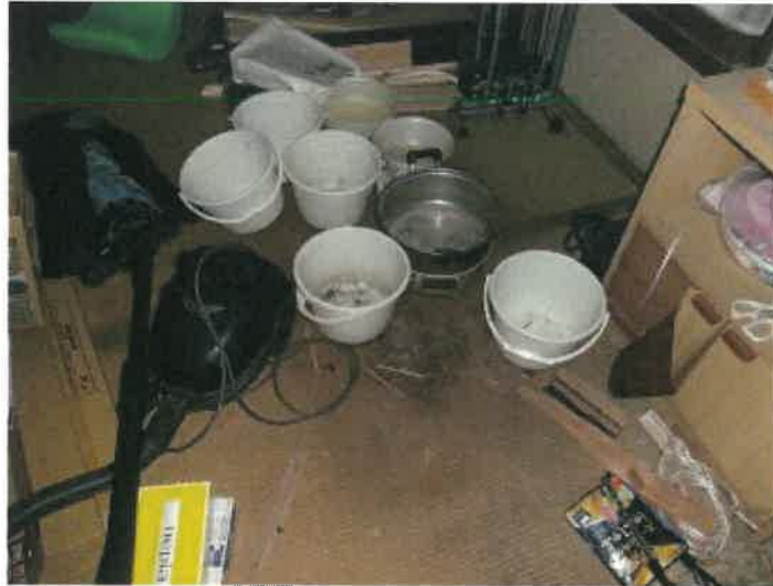
物件4主である建物の1階DK南西側和室（4.5畳）の雨漏りの状況
