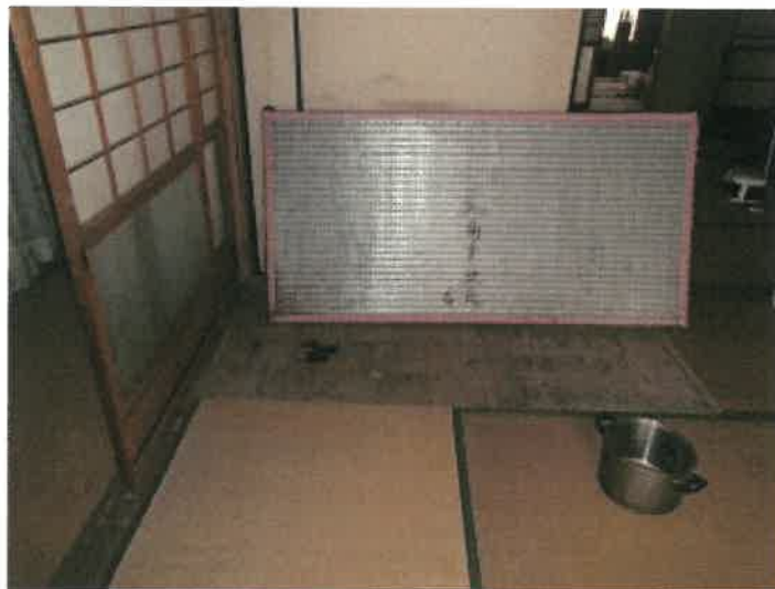
物件 5 建物の 1 階南西側和室の畳の雨漏りによる被害の状況
