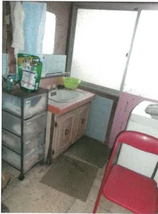
物件4主である建物の1階洗面脱衣所の状況
