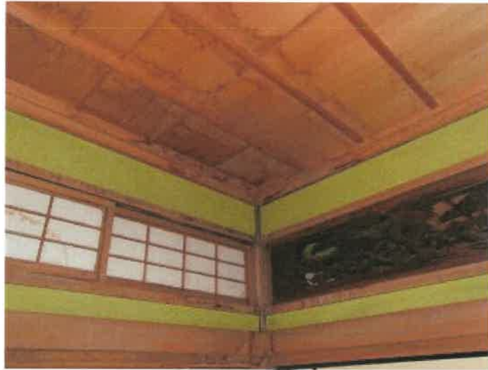
物件 5 建物の 1 階南西側和室の天井の雨漏りの状況
