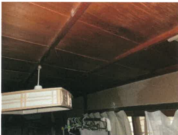
物件4主である建物の1階DK南西側和室（4．5畳）の 南西側和室（物置）の天井の雨漏り痕の状況
