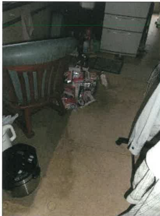
物件4主である建物の1階キッチン周りの床の損傷状況
