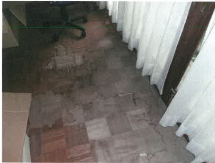
物件4主である建物の1階南角和室(8畳)の南西側縁側（物置）の床の損傷状況
