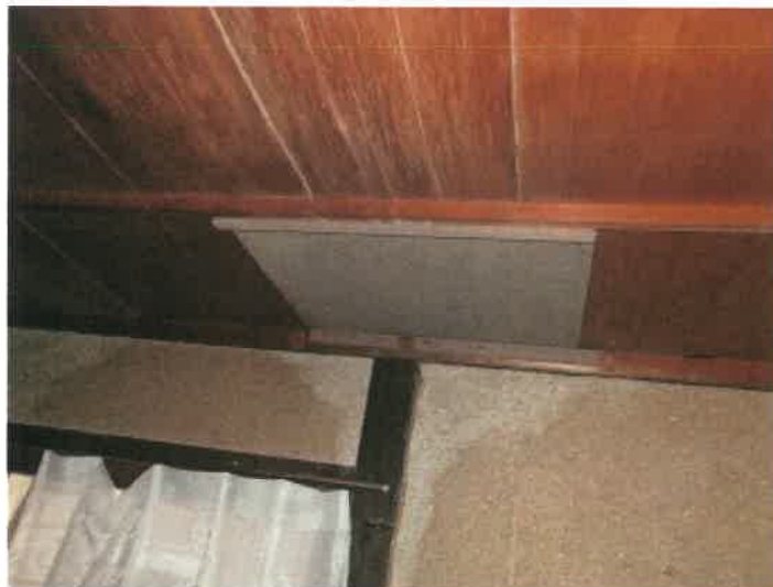
物件4主である建物の1階DK南西側和室（4．5畳）の 南西側和室（物置）の天井の損傷状況
