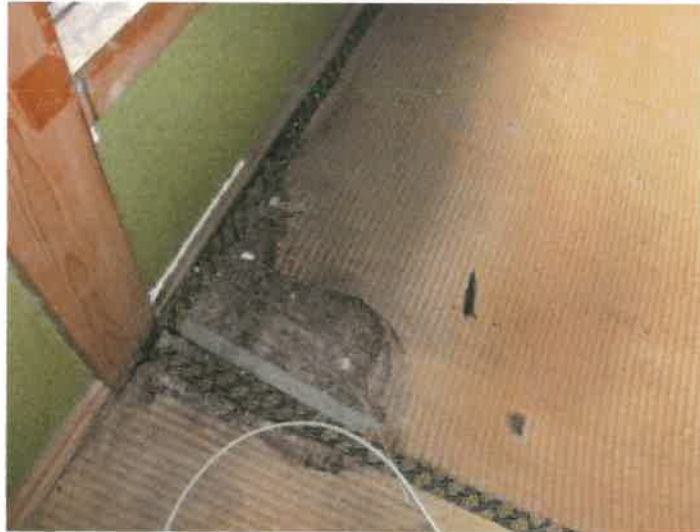
物件 5 建物の 2 階和室西角付近のシロアリによる被害と思われる部分の状況
