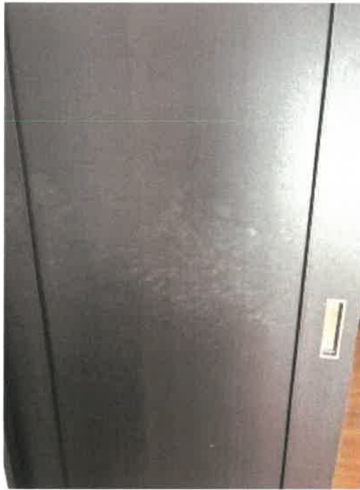
物件 2 2階南東側中央洋室内の引戸の状況
