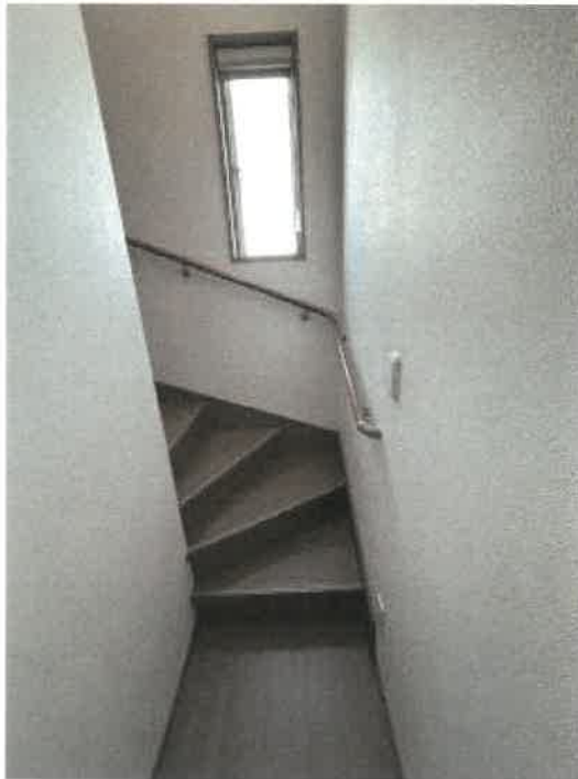
物件 2 階段の状況
