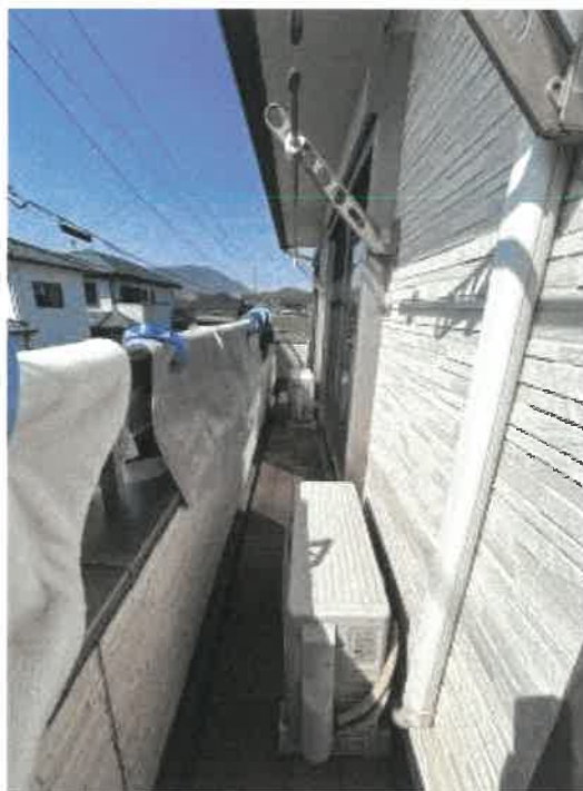
物件2 2階バルコニーの状況
