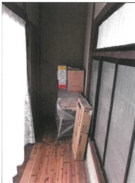
物件 2 建物の 1 階南西端中央の和室 8 畳の南西側広縁の状況
