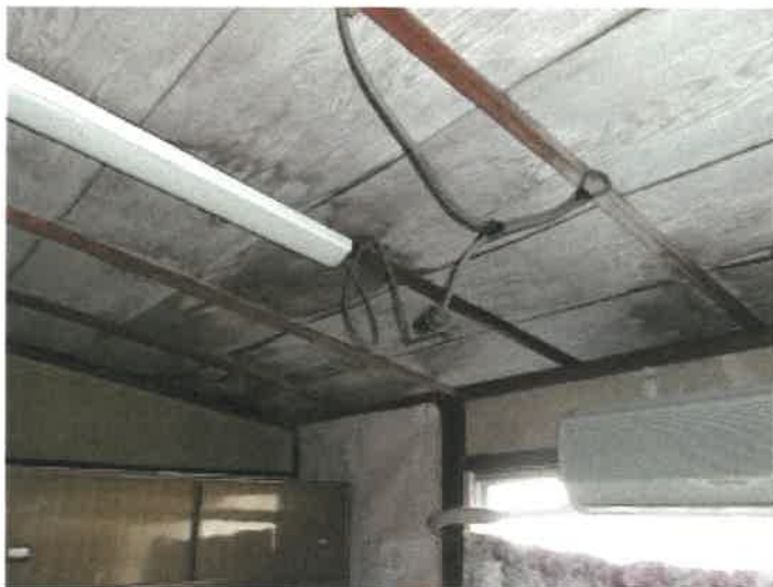
物件 2 建物の 1 階北東側DKの南西側納戸の南西側の和室天井の雨漏り痕の状況
