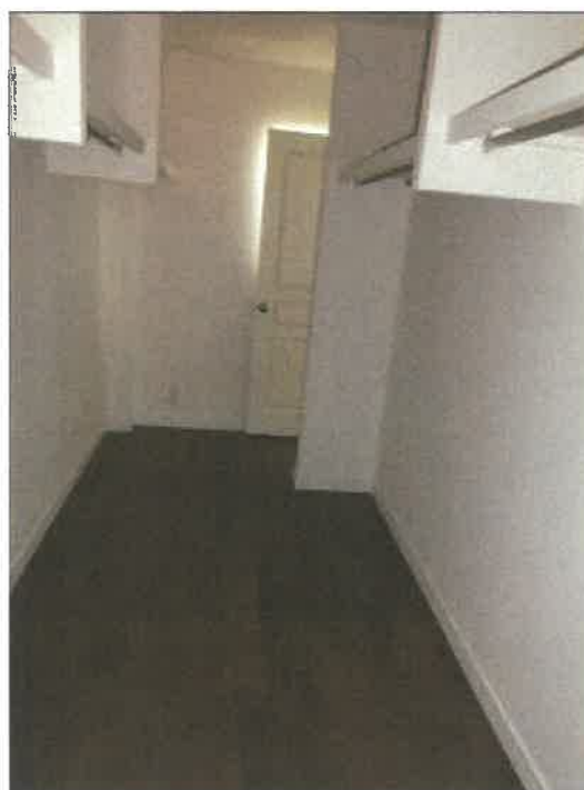
物件 3 建物の 2 階西側納戸の状況
