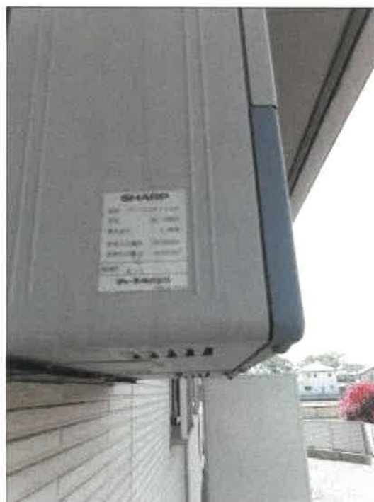
太陽光発電システムパワーコンディショナーの設置状況
