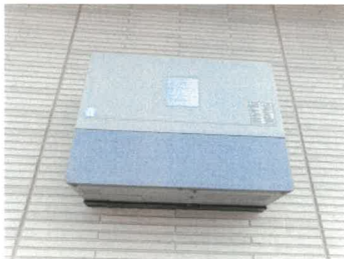
太陽光発電システムパワーコンディショナーの設置状況
