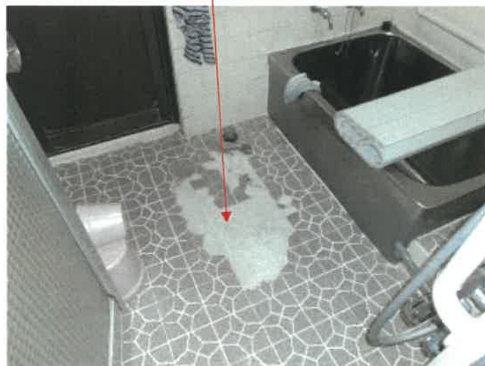
物件 3 主である建物浴室の状況
