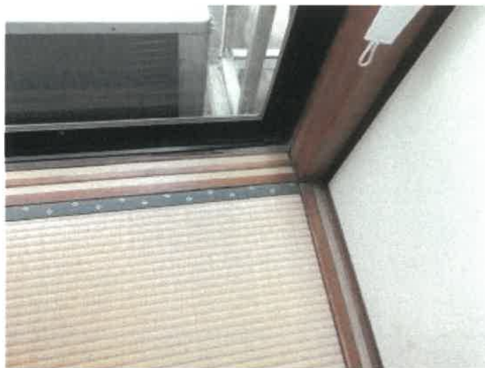
物件3主である建物の西側南和室南側サッシ付近柱のシロアリ被害の状況
