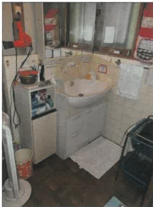
物件 3 主である建物洗面脱衣所の状況 タイル剥がれ箇所
