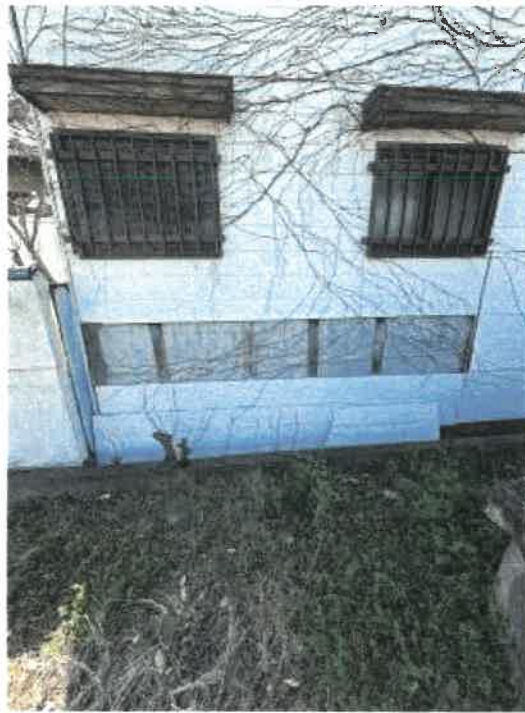
物件2 壁面の破損状況
