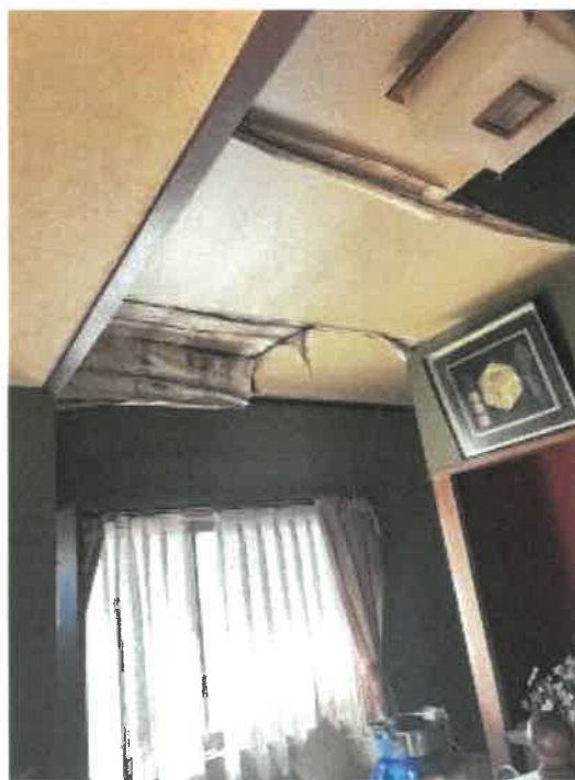
物件 2 玄関ホール上部の状況
