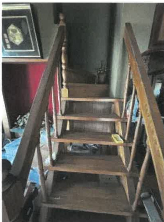
物件2 階段の状況
