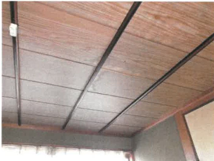
物件2建物の2階北東側和室天井の雨漏り痕の状況
