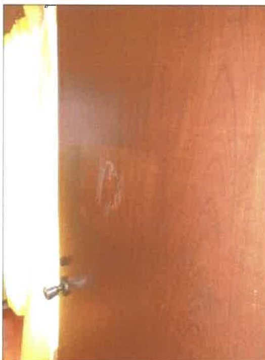
物件2建物の2階南西側洋室の出入口ドアの損傷状況
