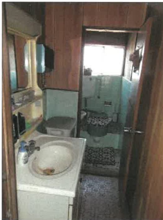
物件 2 建物の 1 階洗面所，トイレの状況
