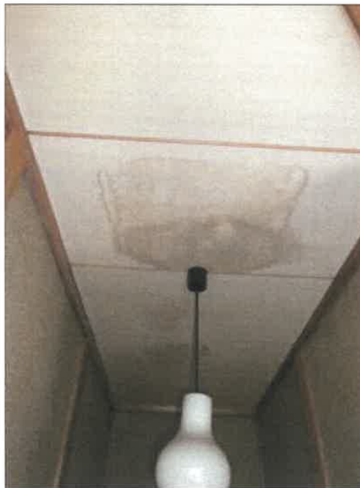
物件2建物の2階廊下天井の雨漏り痕の状況
