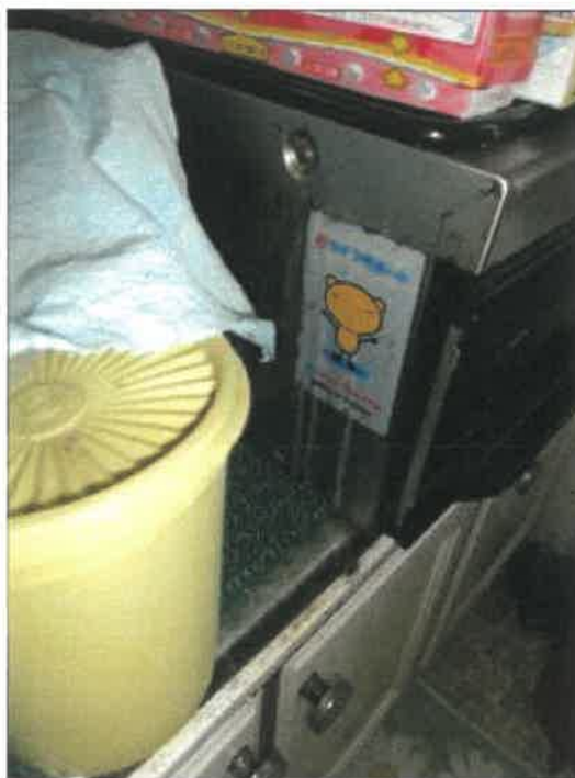
物件2建物の1階キッチンのIHクッキングヒーターのリース票の貼付状況
