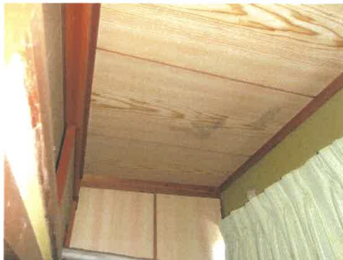
物件 2 建物の 1 階西端和室南側廊下天井の雨漏り痕の状況
