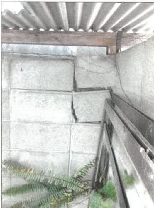
物件2 未登記附属建物の東側壁となっているブロックが損傷している状況
