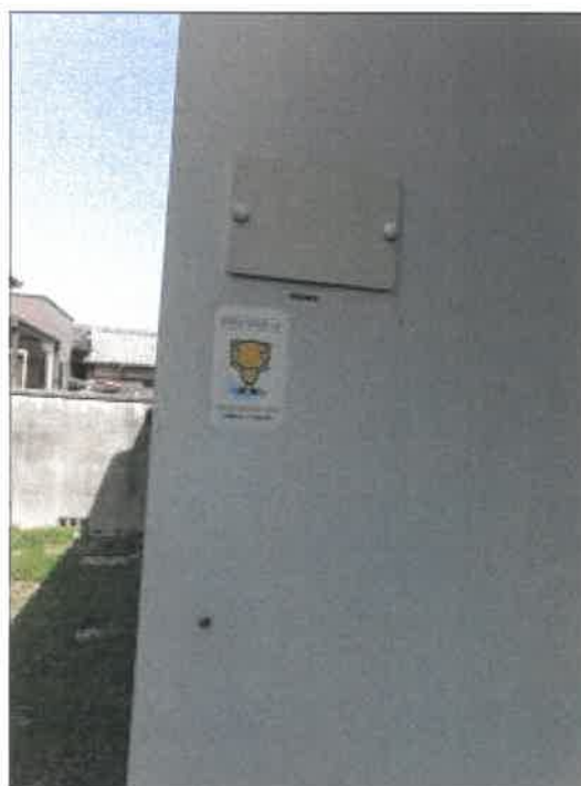
電気温水器のリース票の貼付状況
