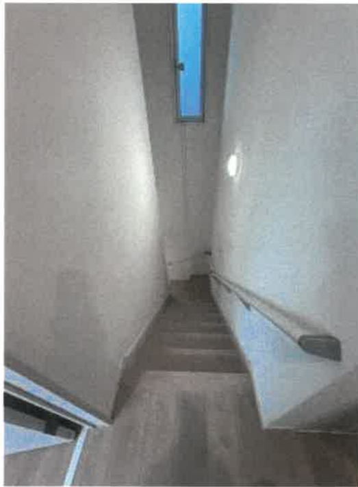
物件 2 階段の状況
