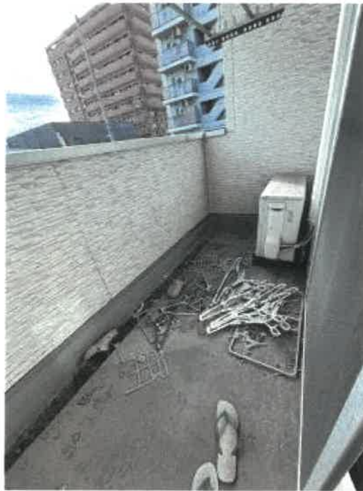
物件2 2階バルコニーの状況
