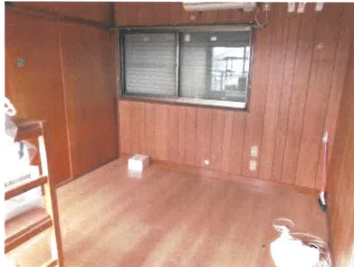
物件 2 建物の 2 階西側洋室の状況
