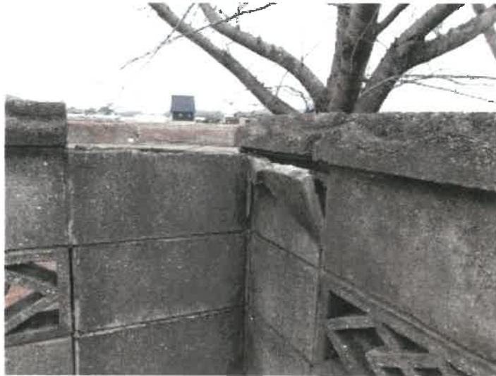
物件1 土地北西角付近のブロック塀の損傷箇所の状況
