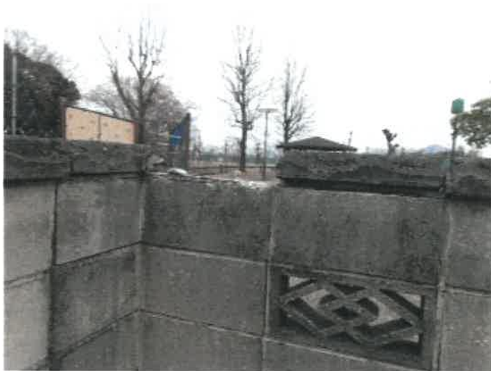
物件1 土地北東角付近のブロック塀の損傷箇所の状況
