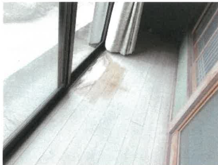
物件 2 建物の 1 階西側南和室の南側廊下の損傷状況
