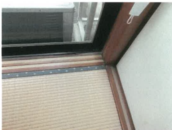
物件3主である建物の西側南和室南側サッシ付近柱のシロアリ被害の状況
