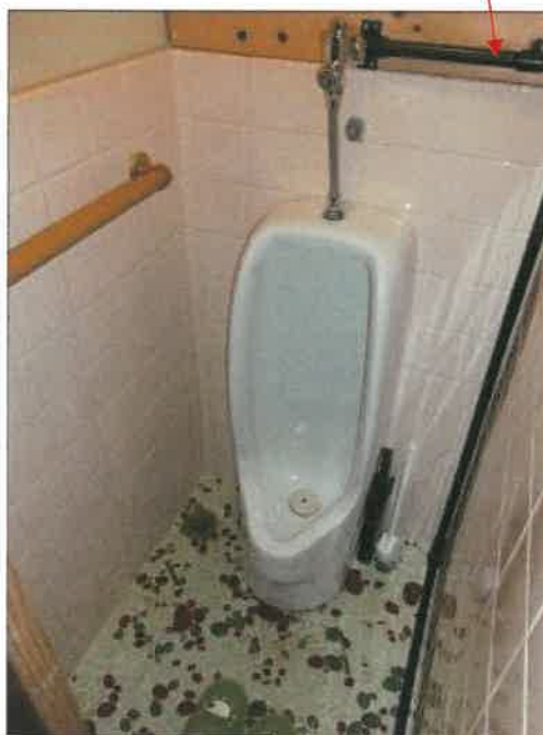
物件 3 主である建物トイレの状況
