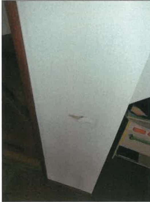
物件 2 建物の 1 階階段上がり口付近壁の損傷状況
