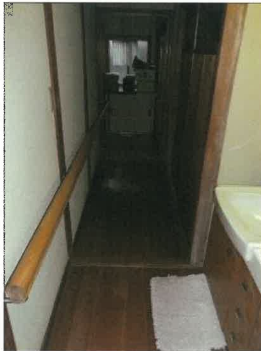
物件3主である建物トイレ前廊下の状況
