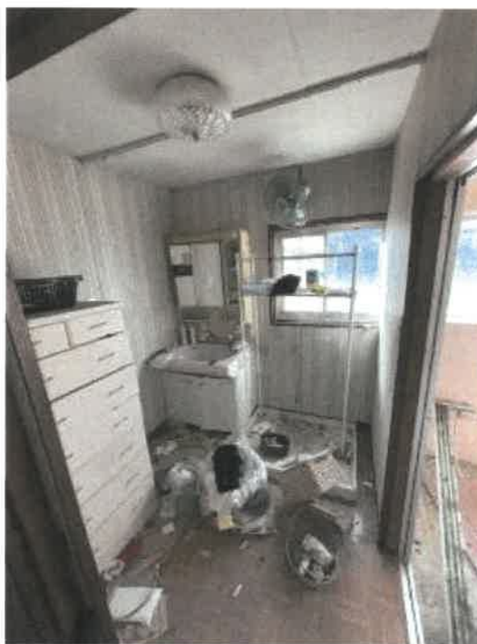
物件3 1階洗面所付近の状況
