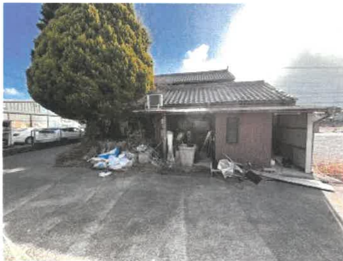
物件3 居宅部分入口付近の状況
