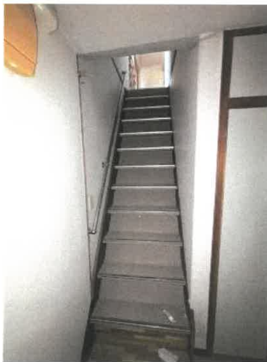
物件3 階段の状況
