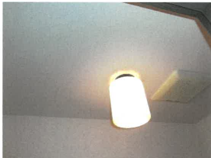
所有者から、「ポトン、ポトンという水が漏れているような音をする」 と指摘のあったトイレの天井の状況
