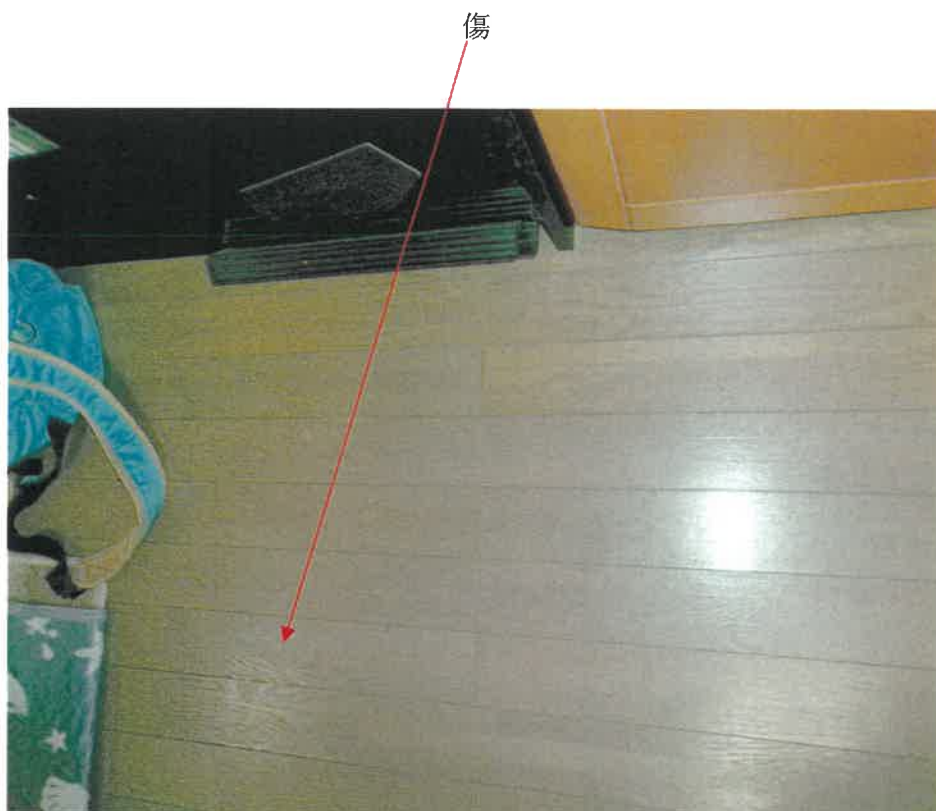
LDの床の傷の状況
