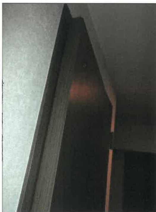
洗面脱衣所出入口ドアが閉まらなくなっている状況
