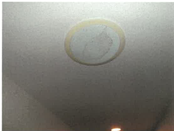
玄関前廊下天井の水漏れ痕の状況
