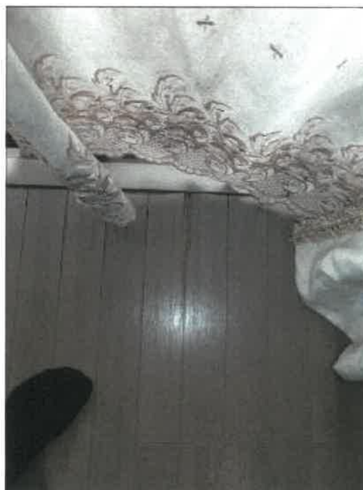
LDの床の損傷状況
