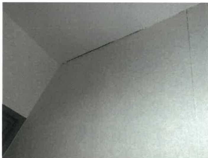
L D K出入口付近天井の壁紙の剥がれ状況
