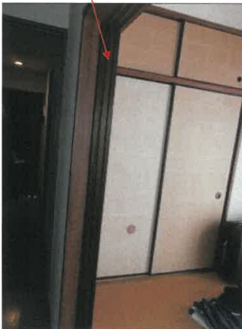
閉まらなくなっている襖の状況
