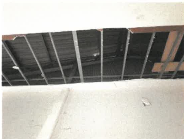
物件3 1階南西側倉庫の天井（西側）の状況
