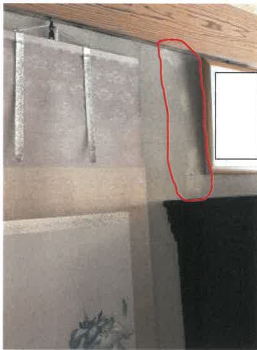
物件 2 4階東側和室の雨漏り跡の状況
