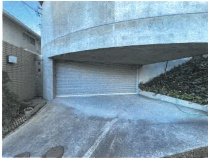
物件2 1階車庫のシャッターの状況
