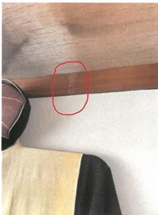
物件 2 4階西側和室の雨漏り跡の状況
