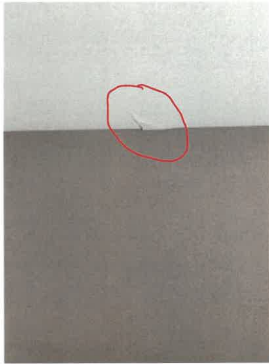
物件2 3階リビング天井の雨漏り跡の状況
