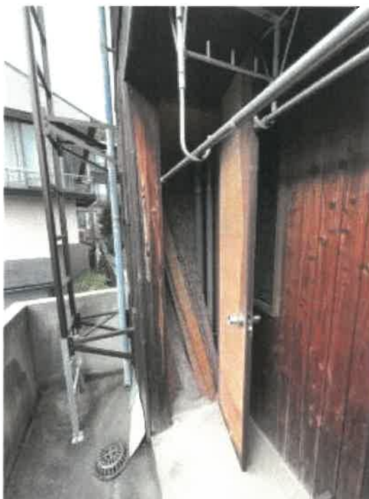
物件2 3階バルコニー西側の物置の状況
