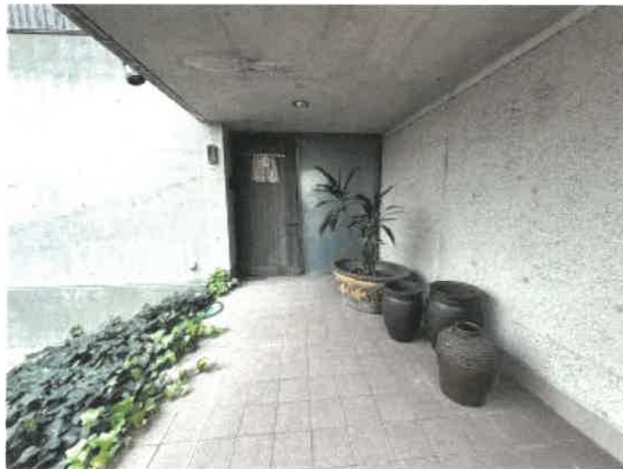
物件2 2階玄関付近の状況
