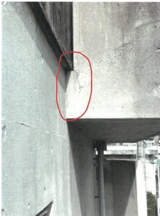
物件2 2階東側外壁のクラックの状況
