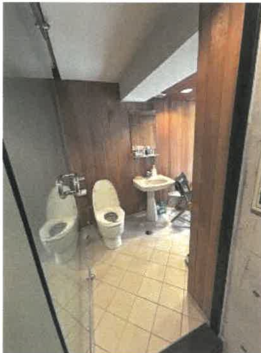
物件 2 1 階南側洋室奥のトイレ・洗面台の状況
