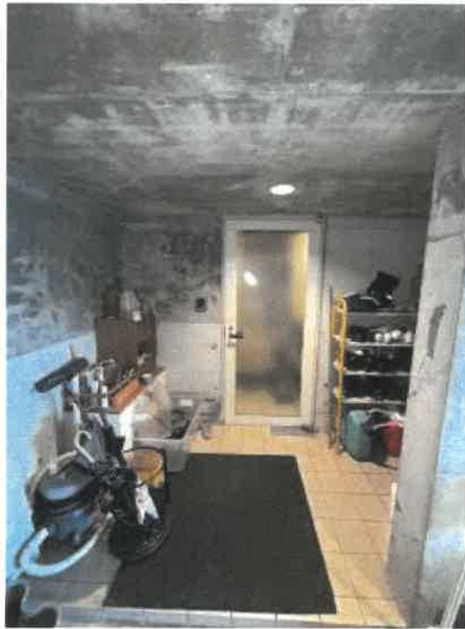
物件 2 1 階車庫西側扉付近の状況
